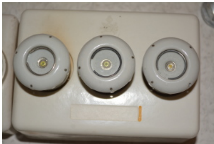
Sikringsgruppen med 3x25A.
